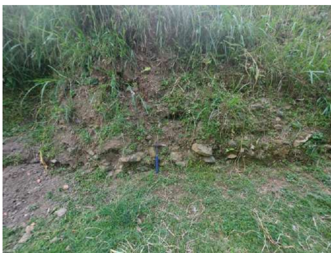
Figura 156. Depósitos de flujo de lodos y escombros, localizados en el centro poblado La Raya.
