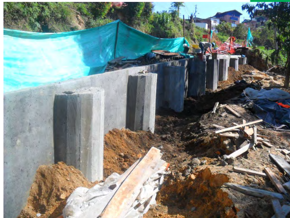
Muro La Corrala $108.004.725
